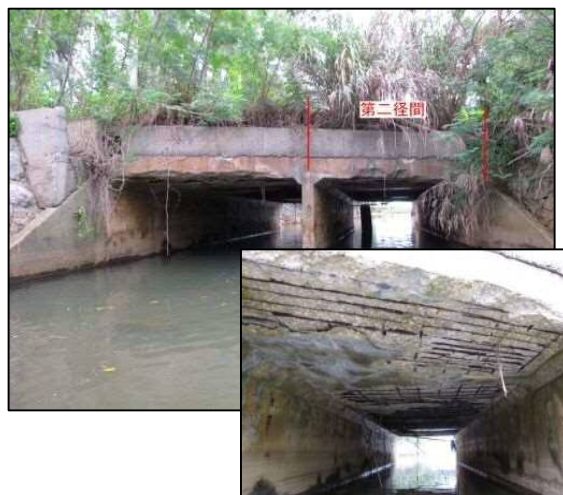
損傷事例（床板の剥離・鉄筋露出）
